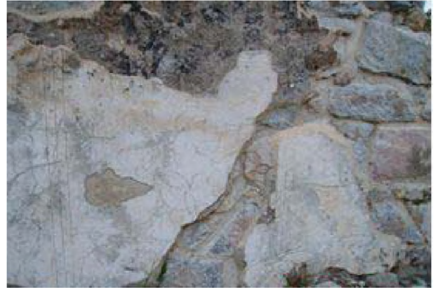
Resim 10: 3 No.lu mezar yapısının yan cephesindeki sıva izleri
