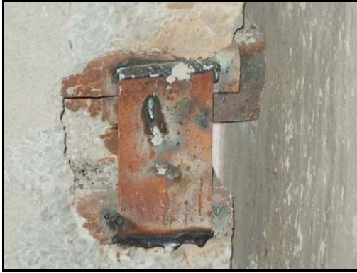
Resim 15. Metal ankraj üzerinde oluşan paslanmalar.
