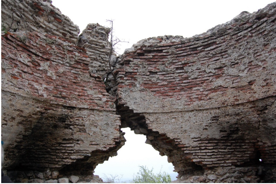
Fotoğraf-7. Eski Manyas Türbe İç Mekan Duvar Çatlakları
