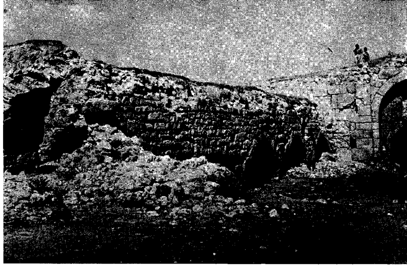
Res. 4 — Konya-Altın- apa Kervansarayı ön av- lusundaki develiklerin son durumu.
