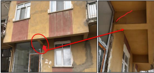
Şekil 3. Kapalı çıkma konsol (ikincil) kirişin hasarı [6]
