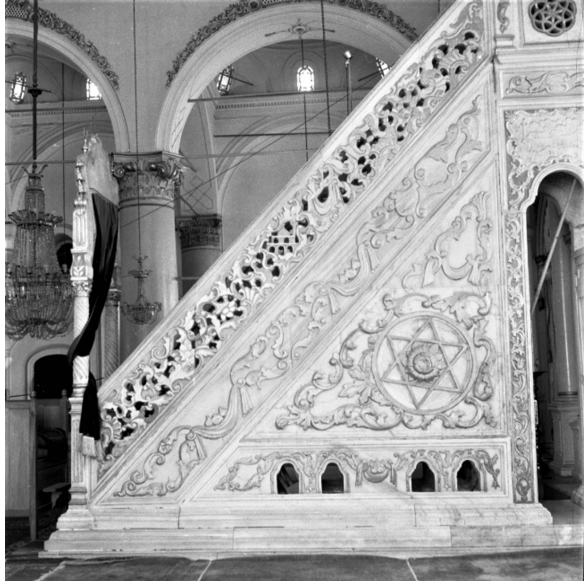
Fotoğraf 31: Onarım öncesi minberden bir görünüm.
