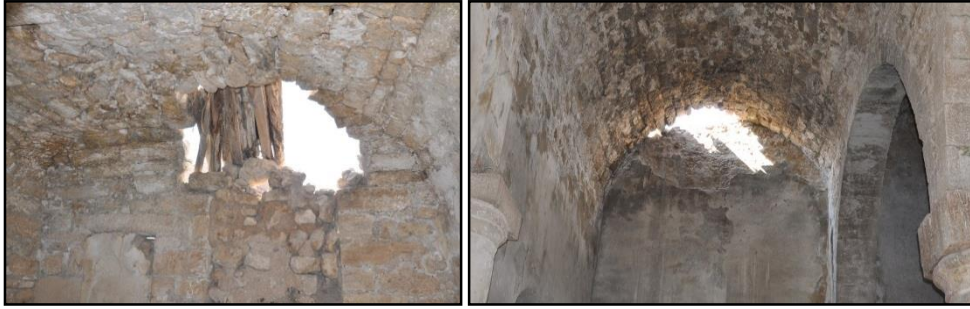
Şekil 27-28: Tavanda ve Tonozlarda Görülen Yapısal Bozulmalar
