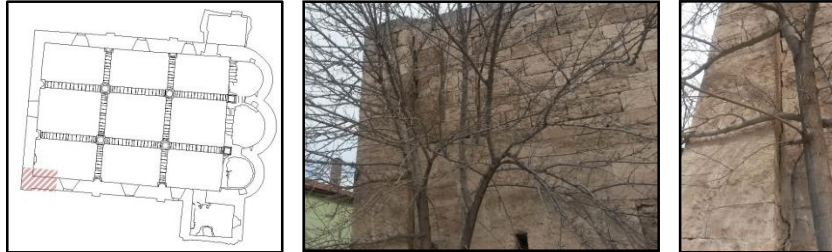
Şekil 42-43-44: Güneybatı Köşesinde Açılma
