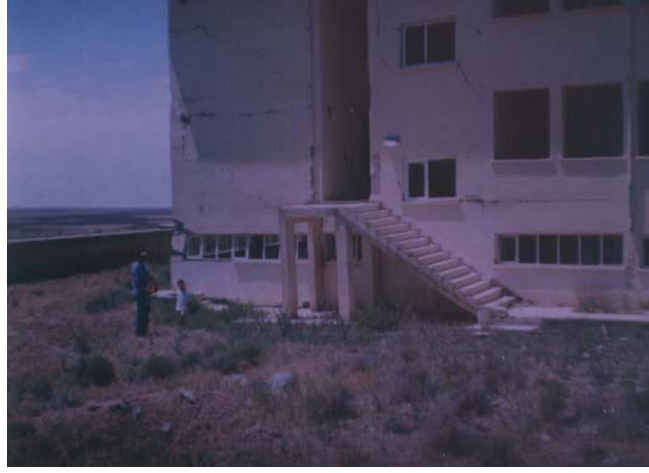
Şekil 4. Okul binasında gözlenen çatlak ve oturmalar [3].
