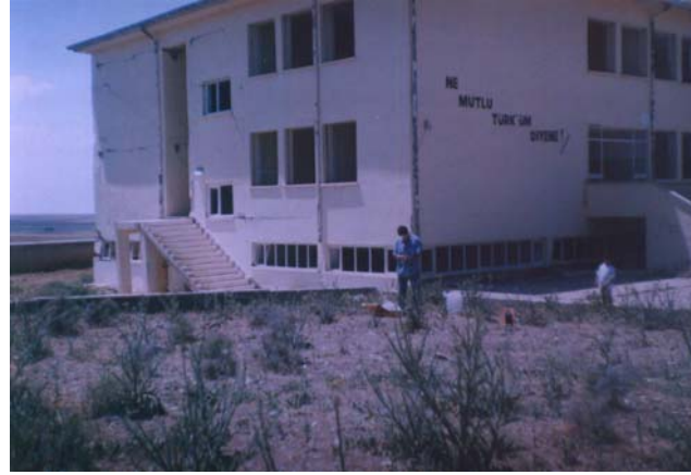
Şekil 5. Okul binasında gözlenen çatlak ve oturmaların farklı görünüşü [3].
