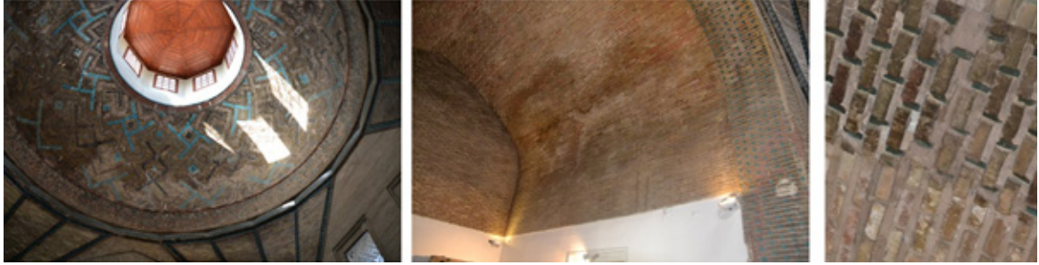
Fotoğraf 15,16,17: Kubbe ve tonozda gözlenen parça kayıpları, bozulmalar
