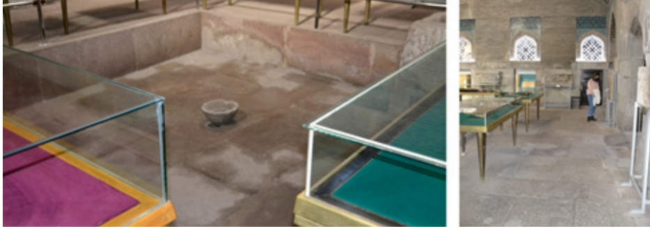
Fotoğraf 11,12: Havuzda ve avlu zemininde gözlenen bozulmalar
