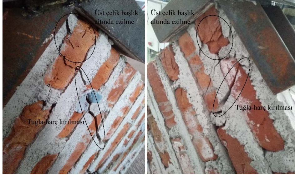
Şekil 7. Üst çelik başlık altında meydana gelen ezilmelere ve tuğla-harç kırılmasına örnekler (Examples of brick-mortar cracking and crushing under the upper steel shoe)
