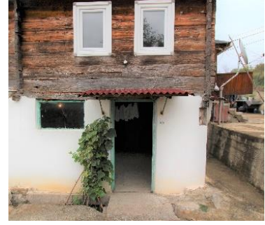
Foto. 56. Zemin kat batı cephe de bulunan ev altına açılan kapı ve çevresi
