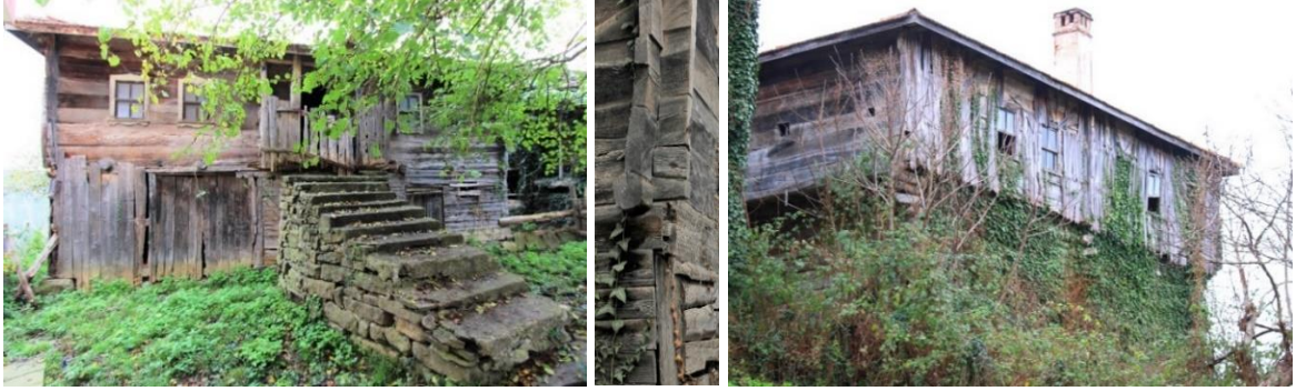
Foto. 5. 1 numaralı evin ön cephesi (solda), Foto 6. 1 numaralı evin kurtboğazı geçmeli ahşap yığma (çantı) duvar ayrıntısı (ortada), Foto. 7. 1 numaralı evin kuzey doğudan görünümü
