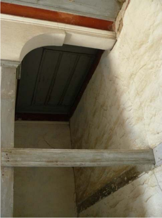
Foto. 7: 1923 yılında yapılan üst katta kuzey-güney yönde uzanan koridoru ikiye bölen bağdadî duvarın doğu yönü.
