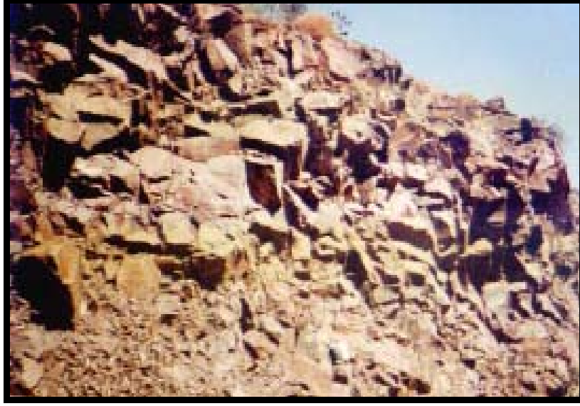
Şekil 5- Bol çatlaklı yapıya sahip andezitlerden bir görünüm
