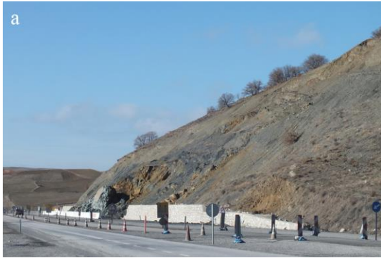
Şekil 5a. 1 Numaralı Heyelan Alanı Figure 5a. Landslide Area Number 1
