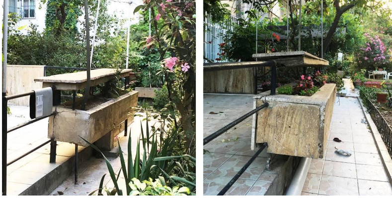
Şekil 30 - Seden Apartmanının (1967) çiçekliklerinden detay (fotoğraf: Yazar, 2018). Traverten kaplaması düştüğü için soldaki resimde betonarme malzeme görülmektedir, sağda ise çiçekliklerin kaplaması görülebilir.
