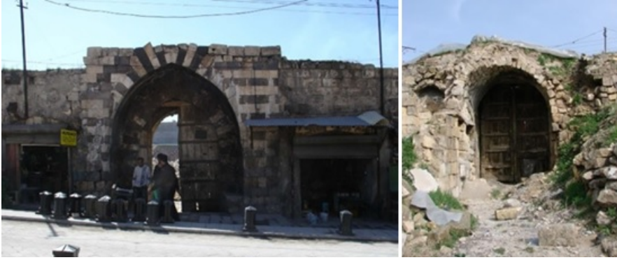
Şekil 1. Restorasyon öncesi giriş kapısı ve ön cephede bulunan dükkânlar ve restorasyon öncesi giriş kapısına avlu içinden bakış (Gaziantep Büyükşehir Belediyesi Restorasyon Kurulu Arşivi Erişim Ocak 2019)
