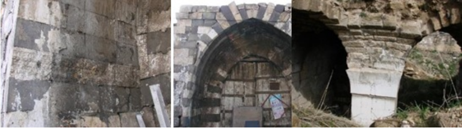
Şekil 4. Restorasyon Öncesi Hışvahan Taç Kapısı / Taç Kapısı Üzengi Taşı ile Revak Ayağı Görünüşü (Kaynak: Gaziantep Büyükşehir Belediyesi Restorasyon Kurulu Arşivi, Erişim Tarihi: 2019)
