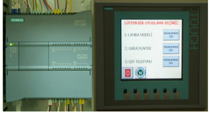
Şekil 2. PLC ve operatör panel görünüşü [6].
