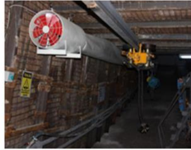
d) Havalandırma Sistemi
