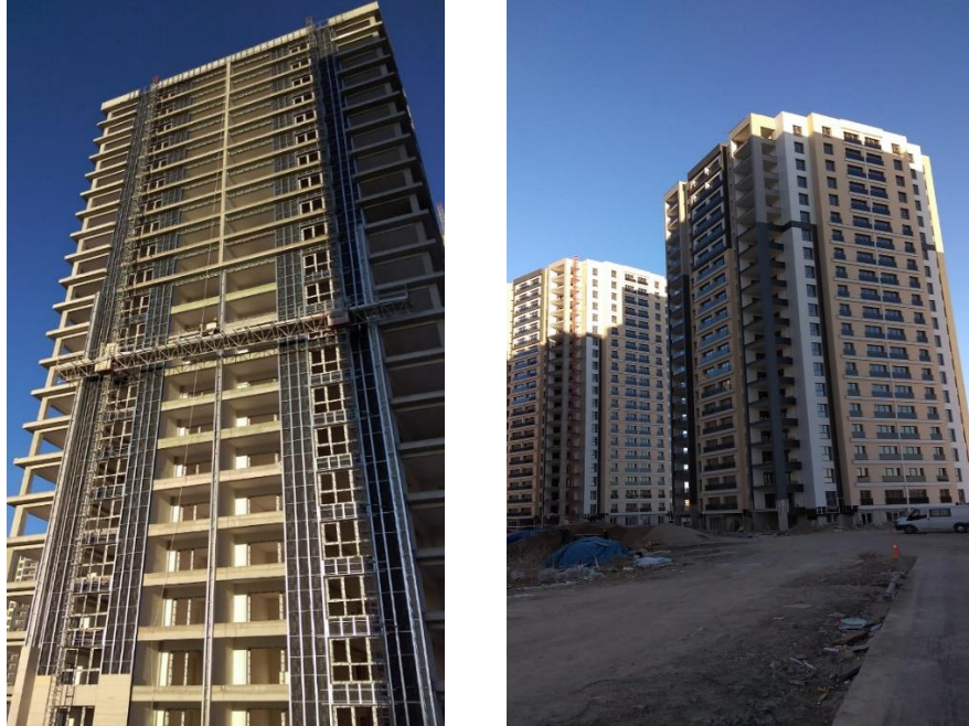
Şekil 4.2. Mevaşehir Eryaman, montaj işlemi devam ederken cephe görünüşü, montaj işlemi tamamlandıktan sonra cephe görünüşü
