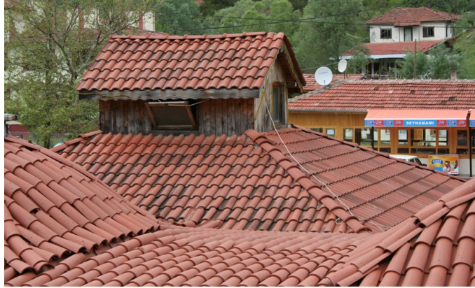
Şekil 35. Sey Hamamı Örtü sistemi, (Erkekler Soyunmalık Bölümü Aydınlık Açıklığı) (Kaynak: Yazarlara ait fotoğraf arşivi)
