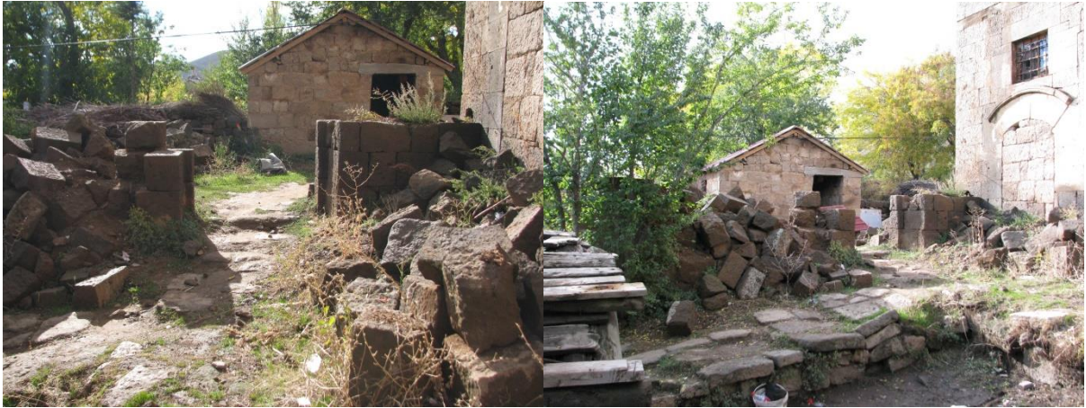
Res. 13, 14: Fikri Kızılkaya Evi Hayat Beden Duvar Hasar Görünüşleri (Ş. Öztürk)
