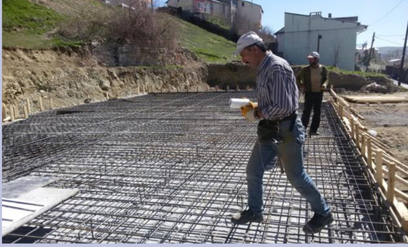
Şekil 4. Beton Kalıbında Demir Bağlama Esnasında Kalıp İçerisine Düşme, Uzun Sıkışması ve Demir Batması Figure 4. Falling into the Mold, Limb Impingement, and Iron Insertion During Rebar Bonding in Concrete Mold
