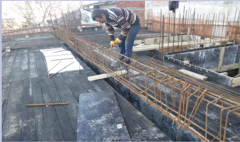
Şekil 2. Beton Kalıbından Düşme Figure 2. Falling from Concrete Mold
