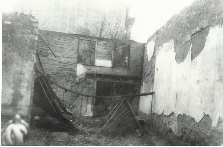
G. 20: Türbe kısmından tevhidhaneye bakış. Çöken pasalı tavan ve giriş cephesinin görünümü. (Encümen Arşivi).
