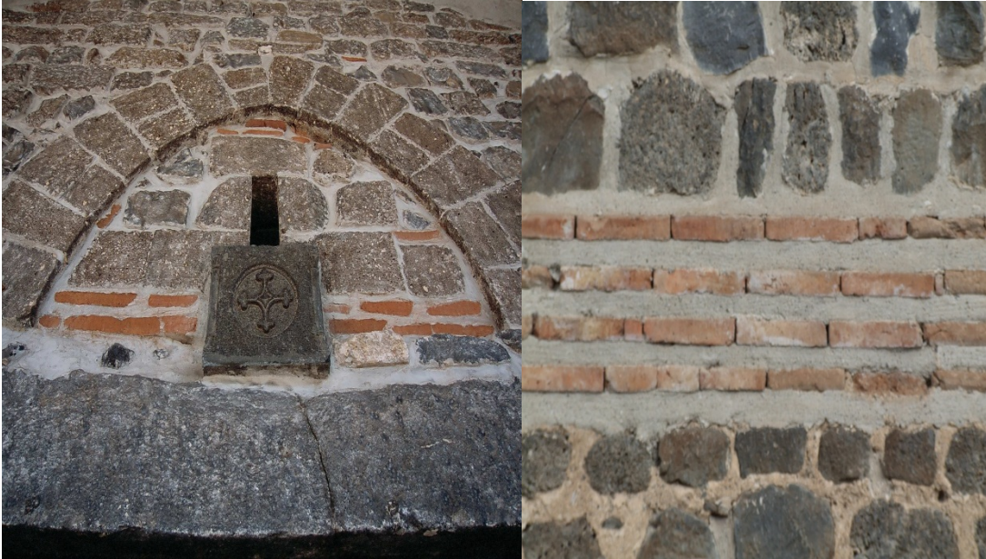
Fotoğraf2: Tuğla ile karışık örülen giriş kemer üstü ve dış cephe duvarı.
