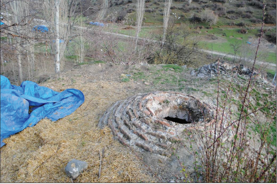
Fotoğraf 20: Hamam Örtü Sistemi
