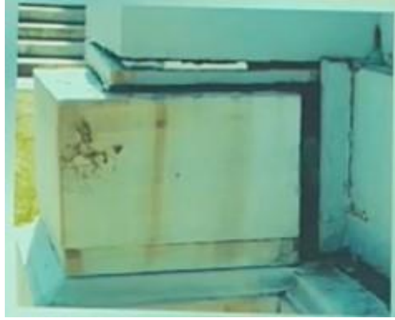
Şekil 13. Bozuk zeminden kaynaklanan hasarlar (TÜRKEV, 2020)
