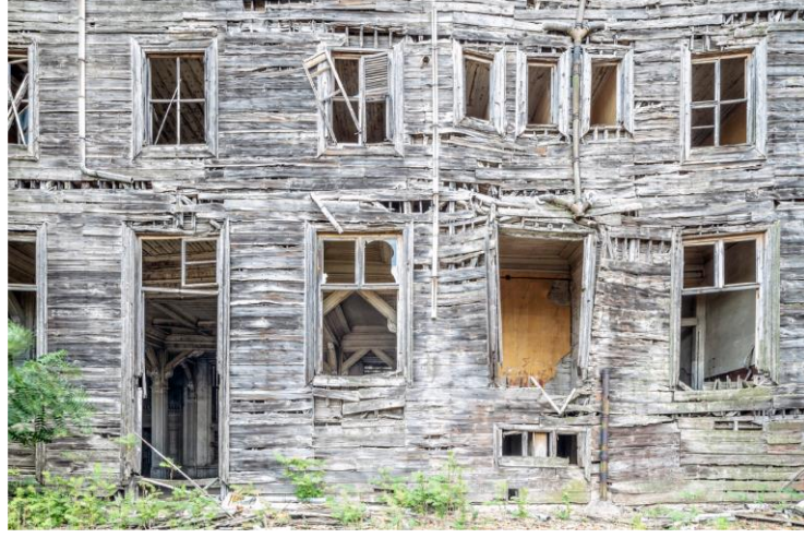
Şekil 8. Yetimhane Cephesindeki Bozulmalar (Germen 2018)
