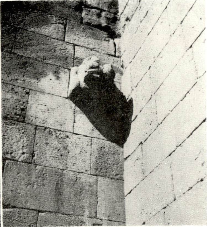
22. res. - Dışta câmîin batı duvarının medreseye bağlandığı köşedeki dilâtasyon.
