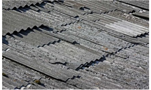
Şekil 2: Asbestli levha ile kaplı bir çatı [14]
