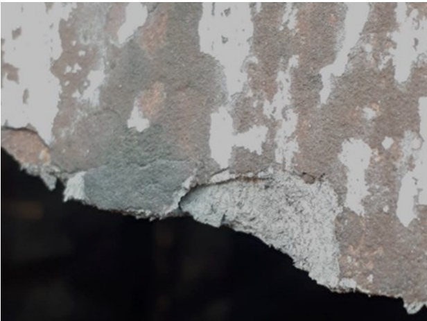
Şekil 4: Hasarlanmış çatı kaplama malzemesi
