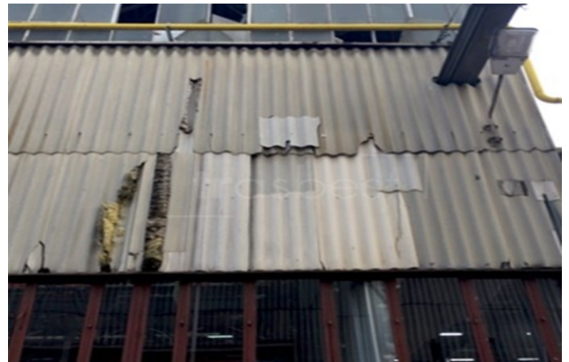
Şekil 3: Asbestli levha ile kaplı bir yan cephe [8]
