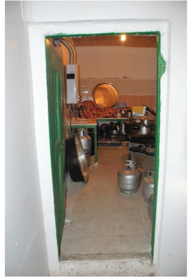
Fotoğraf 7: Kargin'da yer alan yapının mutfak giriş kapısı
