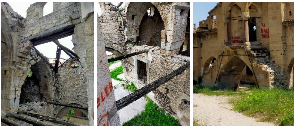
Şekil 21. Çan kulesi ve Narteks kısmındaki bozulmalar [36]
