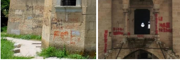
Şekil 20. Doğu ve Batı cephelerindeki vandalizm etkileri [36]
