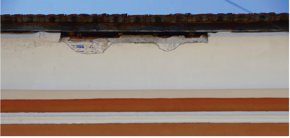
Fot. 4 - Ödemiş Ulu Cami, saçakta yer alan kalemişi kalıntıları.
