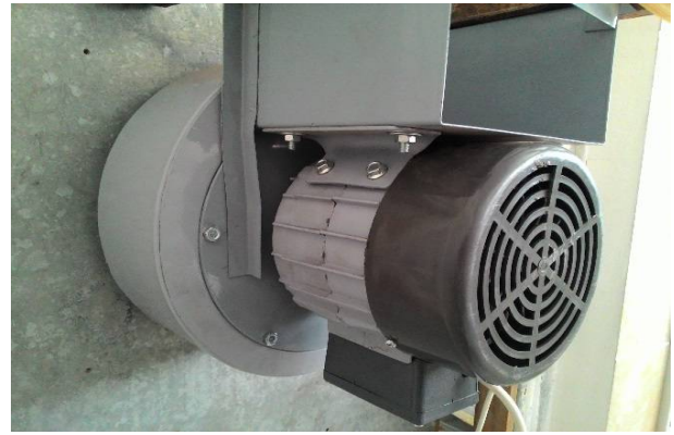
Şekil 2. Havalandırma ünitesi. Figure 2. Ventilation unit.
