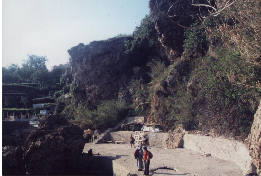
Foto 1: Eski Lara yolundaki falez sahasında, düşme riski taşıyan kaya bloklarına doğudan batıya bakış.
