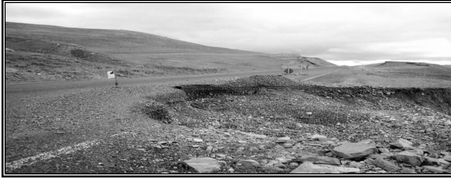
Fotoğraf 4. D950 karayolu Tuzla Çayı kenarından geçirildiği için zaman zaman alttan oyulmalar yolun göçmesine neden olmaktadır (Erzurum-Çat 28.06.2004).
