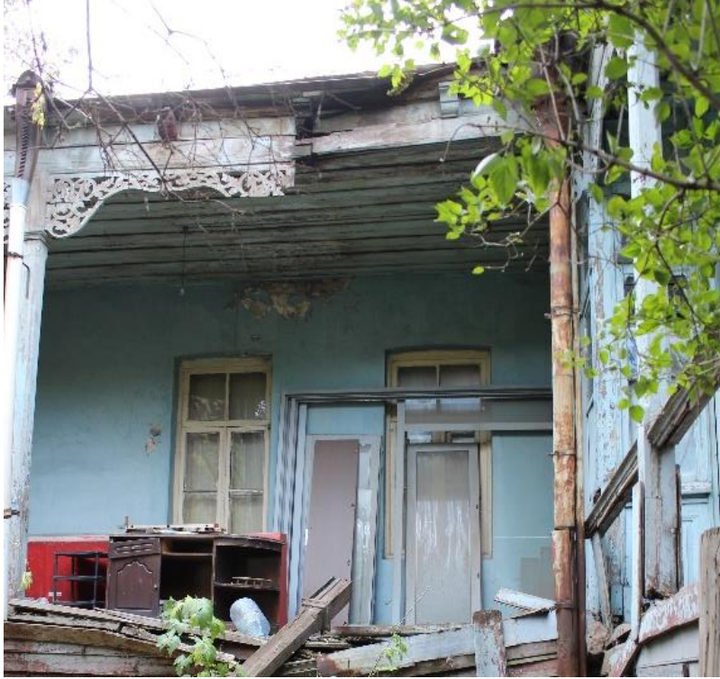
Fotoğraf 6: Topçu Evi verandasındaki bozulma.
