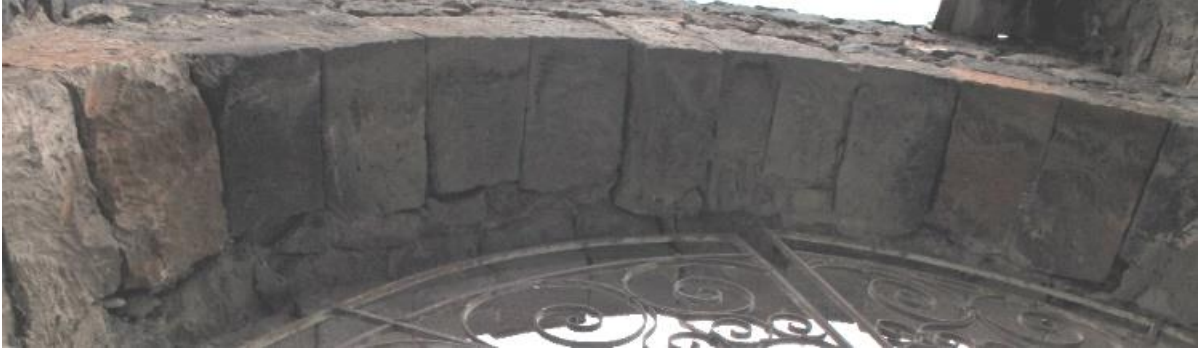
Fotoğraf 7: Kemerli avlu kapısındaki denge problemi.
