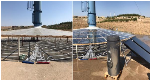
Şekil 5. Güneş enerjili sıcak su sistemi döşenmiş toplayıcı alanı [14].
