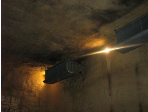
Şekil 5. PU köpük malzemesinde meydana gelen kararma ve deformasyonlar Figure 5. Darkening and deformations occurring in PU foam material
