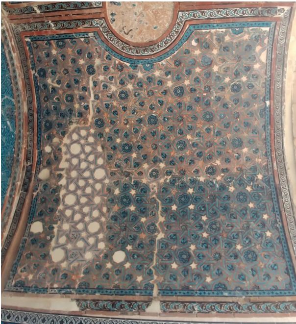
Resim 14. Medrese, Güney Eyvan Tonoz Örtü, Çatlak (Konak)
