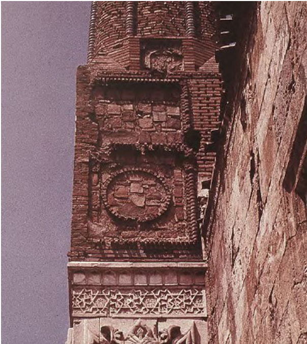
Resim 1. Medrese, Güney Minare Kaide Kısmı, Güney Cephe, Birim Malzeme Kaybı (Tuncer, 2008)
