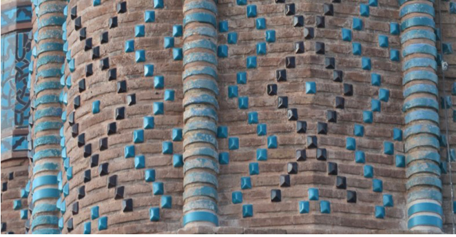
Resim 2. Medrese, Güney Minare, Güney-Batı Cephe Silmeler, Parça Kaybı (Konak)
