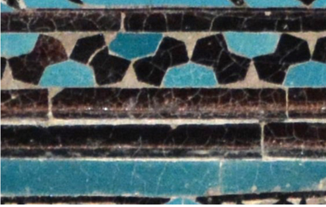
Resim 10. Mescit, Mihrap Kuşak, Çatlak (Konak)
