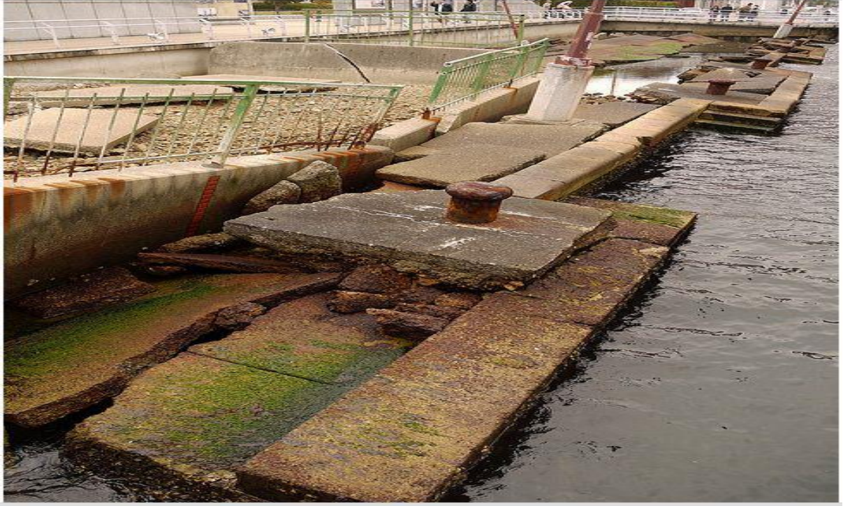
Şekil 1. Deprem nedeniyle kıyı yapısında meydana gelen deformasyon.
