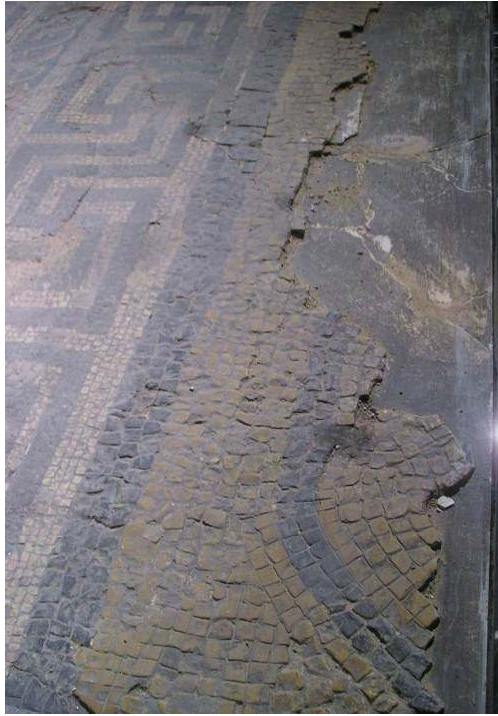
Fig. 4: Elverişsiz depolama, teşhir ve diğerk nedenlerle oluşank çatlak
