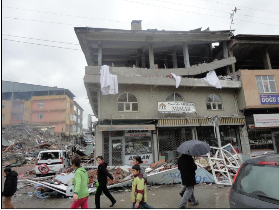
Şekil 1. Ara kattan dolayı oluşan deprem hasarı
