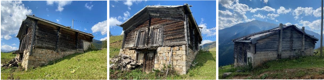
Şekil 5: Aşhanesi Bacasız, Balkonu Yıkılmış ve B Tipi Plana Sahip G9 Konutu (Topcu, 2021).
