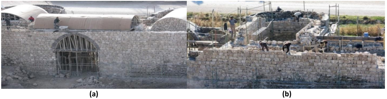
Şekil 31. Saray Kapısı (a) Onarım çalışması görünüşleri; (b) Onarım çalışması görünüşleri (Kaynak: (a,b) Yazarın kişisel arşivi, 2012).
