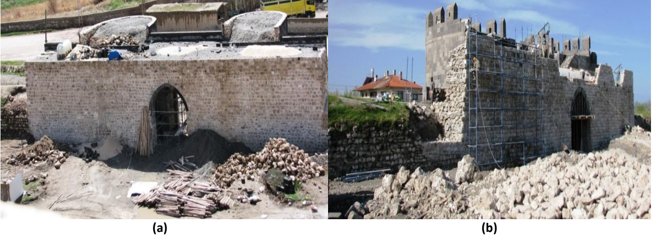
Şekil 33. Saray Kapısı (a) Onarım çalışması görüşleri; (b) Onarım çalışması görüşleri ( Kaynak: (a,b) Yazarın kişisel arşivi, 2012).
