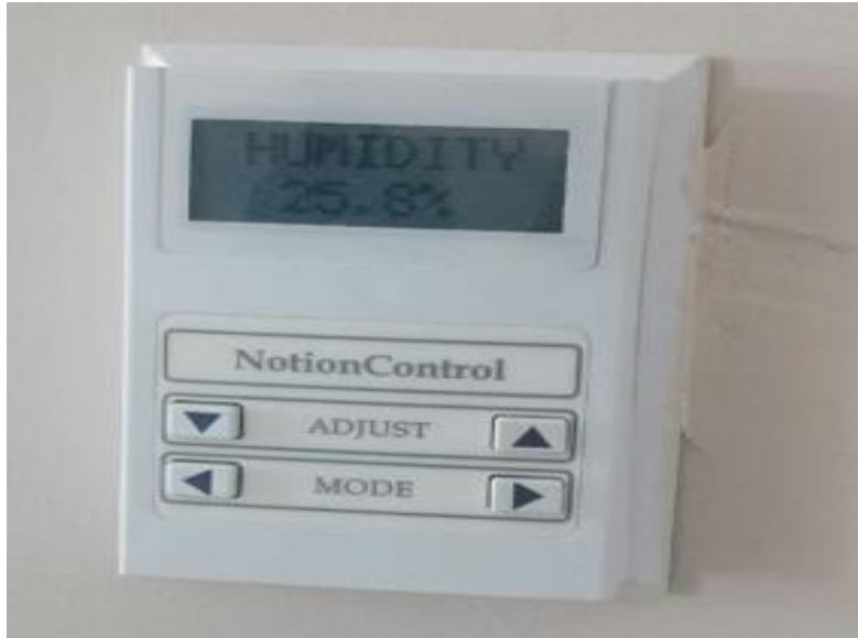
Şekil 10. İç hava kalitesi cihazı (CO 2 , bağıl nem, sıcaklık) Figure 10. Indoor air quality device (CO 2 , relative humidity, temperature)
