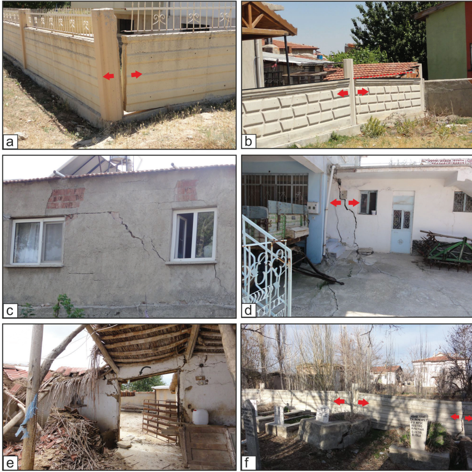
Şekil 9. Bolvadin yerleşim alanı içerisinde gözlenen deformasyonlar a-b) Akçan parkı yakınında, yüzey faylanması üzerindeki binaların bahçe duvarının düşen bloğa doğru rotasyonel hareketi sonucu oluşan açılmalar, c-d-e) Yüzey faylanması üzerinde yer alan binalarda gözlenen deformasyonlar. f) Bolvadin mezarlığı KD duvarı üzerinde gözlenen deformasyonlar
