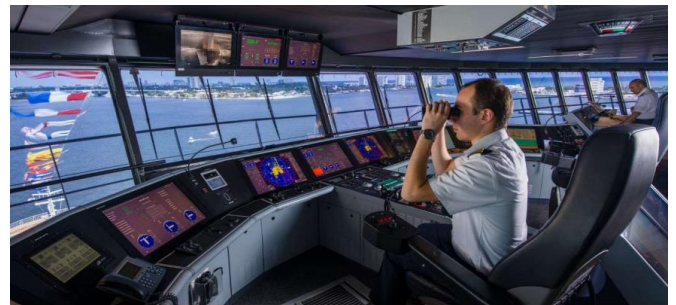
Şekil 5. Entegre Köprüüstü Sistemi
