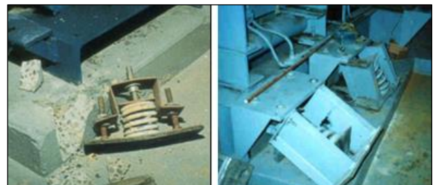
Şekil 20 Hatalı kullanım nedeniyle zarar gören sismik izolatörler [19]
