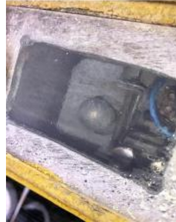
Şekil 2 Mekanik sismik topunun şalter üzerindeki görünümü [8]
