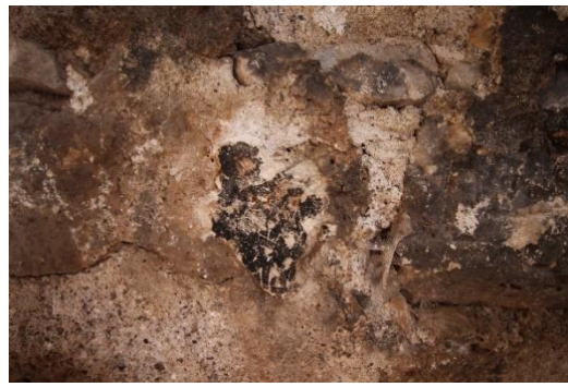
Fotoğraf 13 Duvarlarda is lekesi
