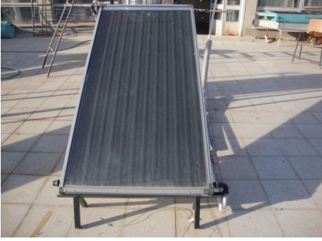
Şekil 2. Düzlemsel yüzeyli güneş kolektörü
