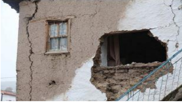
Şekil 16. Malatya Battalgazi’de hatıl eksikliğine ve bakımsızlığa bağlı olarak deprem etkisiyle yıkılan bir kerpiç duvar [48]
