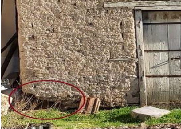
Şekil 14. Malatya Karaca köyünde subasmanın toprak altında kalması nedeniyle zarar gören kerpiç duvar, 2021
