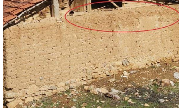
Şekil 12. Malatya Seyituşağı köyünde sıvanmayan bir kerpiç duvardaki aşınma ve dökülme, 2021
