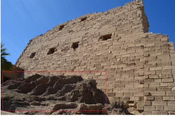
Şekil 4. Antik Mısır'da, Luksor kentinde tapınak duvarının yapımı için inşa edilen kerpiç duvarın kalıntısı, 2018
